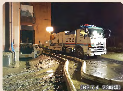
国交省ポンプ車による緊急排水状況 ※写真提供:国土交通省九州地方整備局
