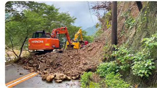
【災害協定に基づく応急復旧工事】 提供：熊本県建設業協会
