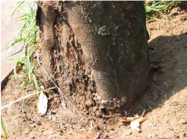
シロアリによる腐朽
