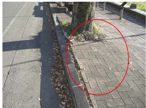
樹幹の肥大化に伴う狭い植栽周囲 の舗装隆起・縁石損傷の例
