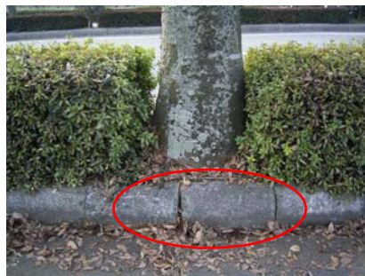
肥大化による縁石の押し出し事例
