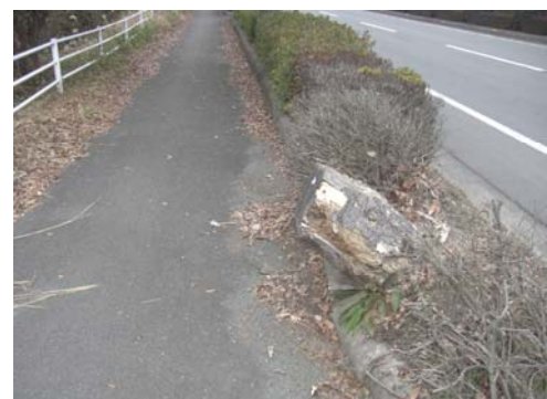
倒伏して伐採された切株の放置
