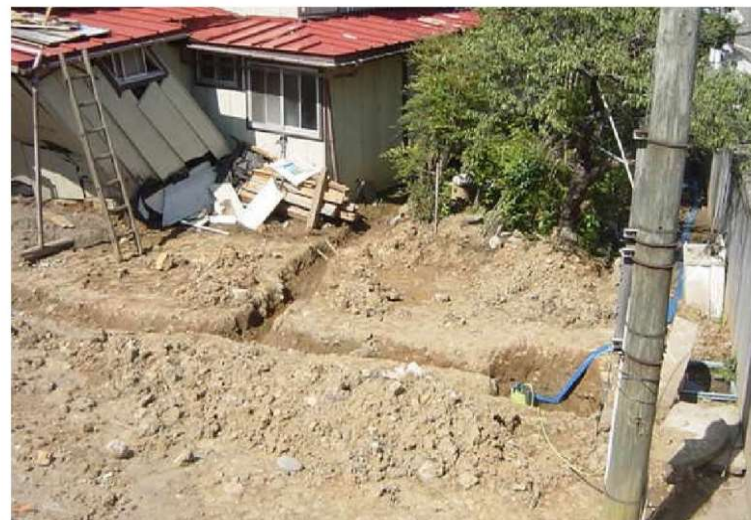
(b) 地震により湧水が出た箇所
