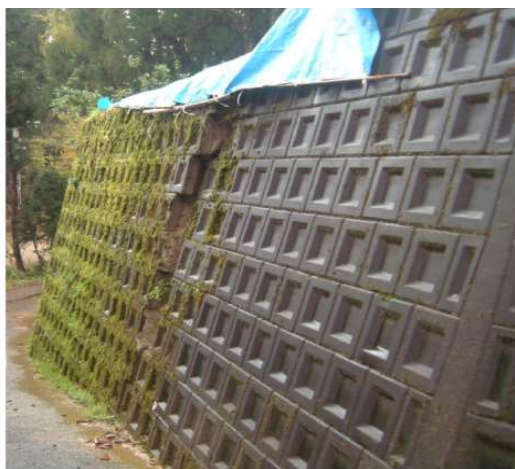
(a) 水抜穴が無い前傾した擁壁
