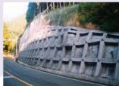
■斜面崩壊を防止する法面工
