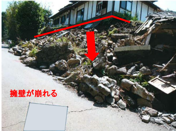
全面的な崩壊が生じた空石積造擁壁
