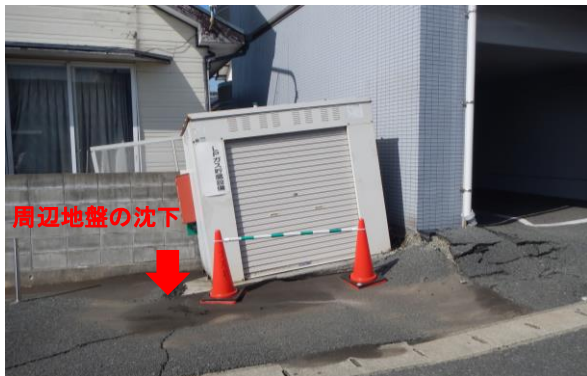
宅地地盤の沈下
