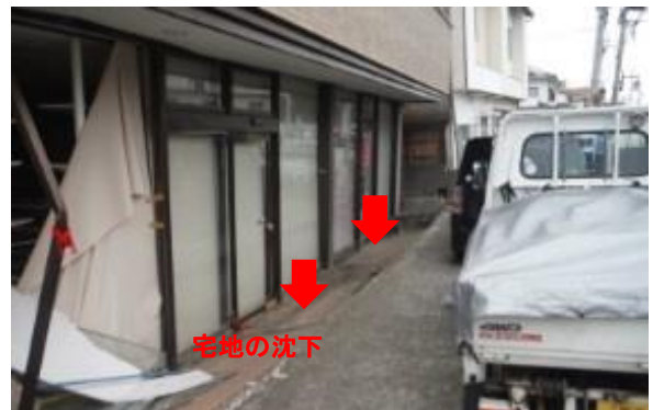
宅地の沈下による道路との段差
