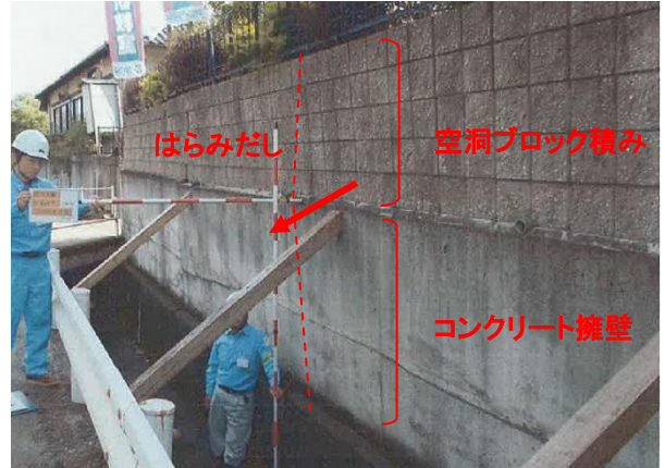
増し積み擁壁境界部のはらみだし
