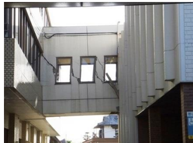
図 1.2.8 渡り廊下の被害
