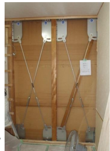
図 4.2.1 天井、床を解体せずに壁を補強する低コストの改修 (写真:NPO 耐震化アドバイザー協議会)
