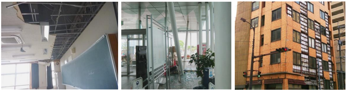
図 4.5.1 非構造部材の被害(天井・窓ガラス・外壁)
