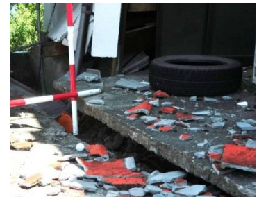
図 1.2.12 建築物の外周地盤の沈下
