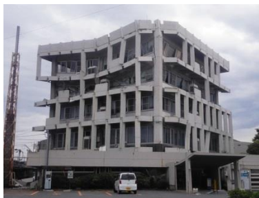
図 1.2.7 庁舎棟の局部崩壊
