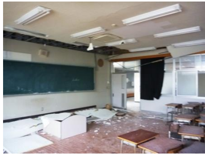
図 1.2.5 天井の脱落(校舎)
