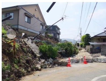
図 1.2.10 盛土擁壁の被害
