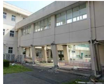
図 1.2.6 渡り廊下の倒壊(校舎) (写真:熊本県教育委員会)
