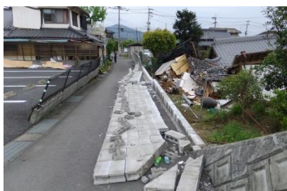
図 1.2.13 ブロック塀の倒壊
