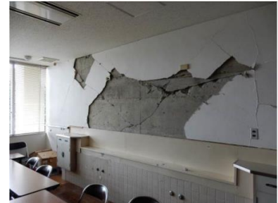
図 1.2.9 耐力壁のせん断ひび割れ (写真:国立研究開発法人 建築研究所)
