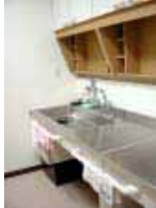
車いす使用者対応の流し台
