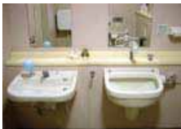
手洗器とオストメイト対応設備(温水シャワー付)
