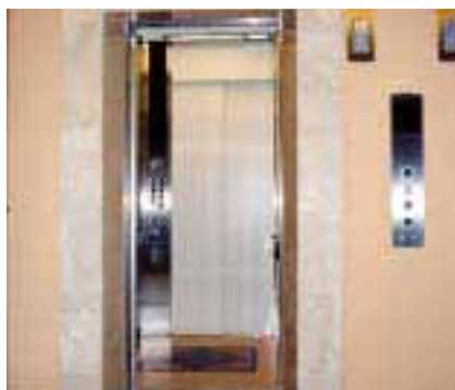
管理部門と来客部門の間に設けられた2方向エレベーターの設置例(R&B熊本ワシントン通)
