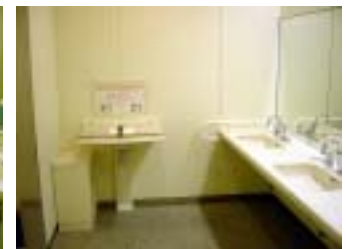
洗面所に設けられたペーパーシート (男女共通)
