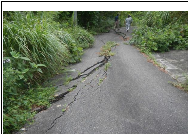
町道に生じた亀裂
