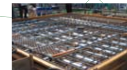
モックアップには配筋やPC鋼線配筋用のシース管をセット
