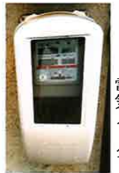
電気メーター
