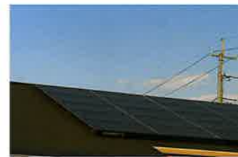
太陽光パネル
