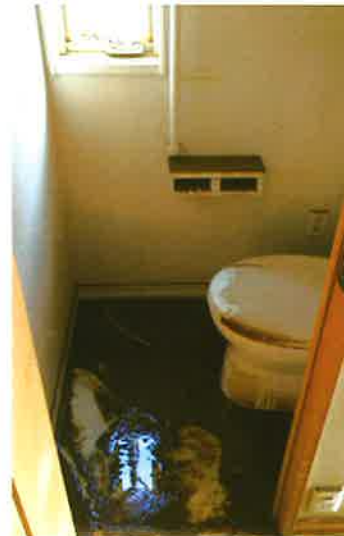
浸水したトイレの様子
