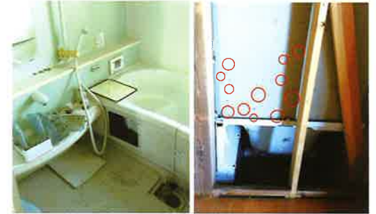
壁裏に発生したカビ
